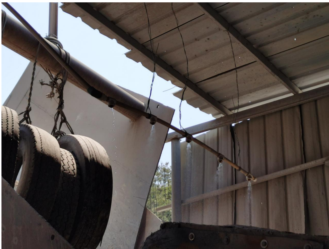
图 3-5 原料破碎洒水降尘处理装置图
